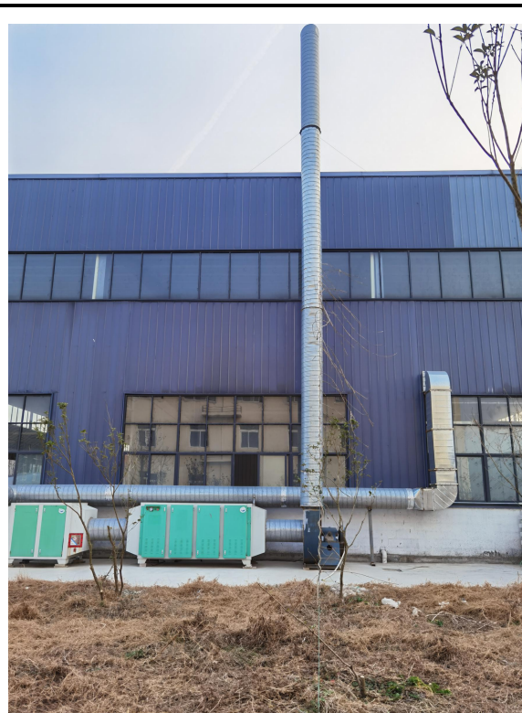
图4-5 固化废气排气筒
