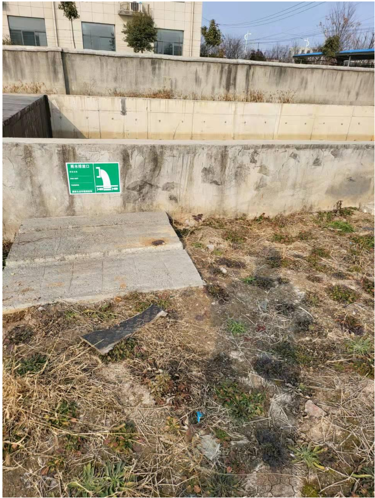
图4-2 雨水排口标志
