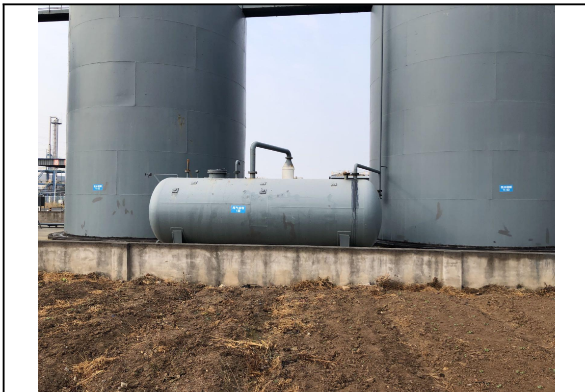
图4-2 废气环保设施
