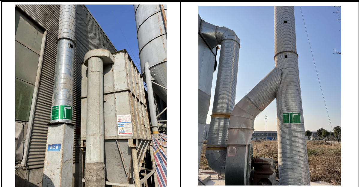
图4-2 废气环保设施及环保标识牌
