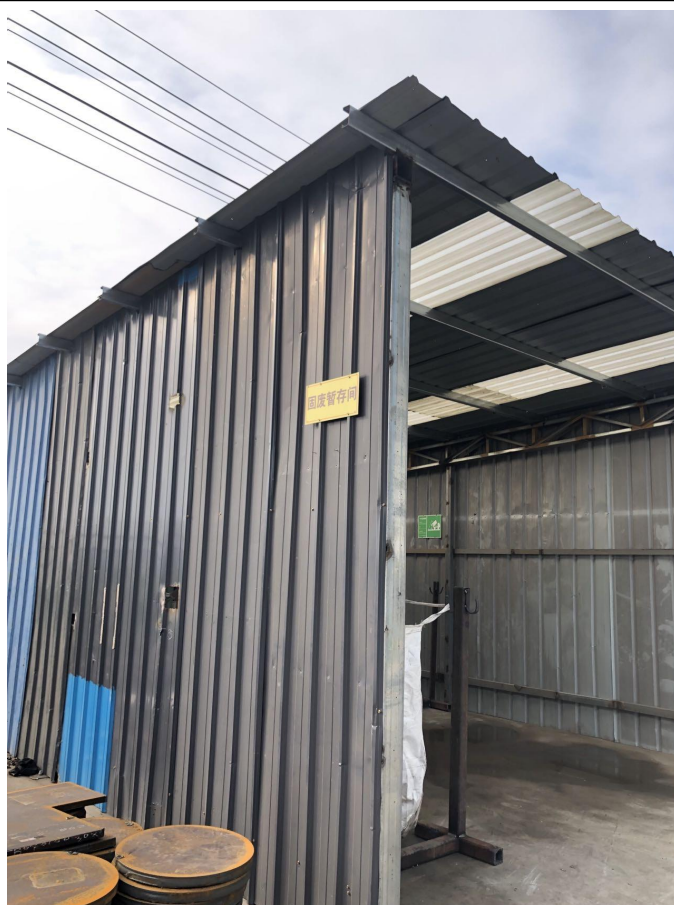
图4-9 一般固废暂存间
