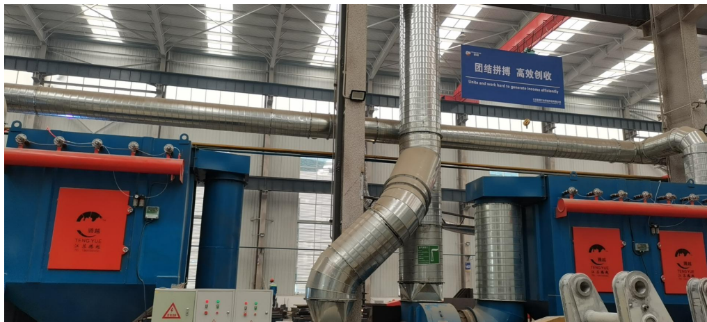
图4-4 滤筒除尘器处理通过15m排气筒
