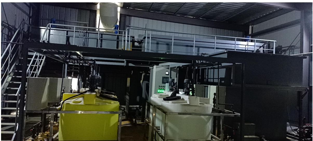
4.1-3 本项目二期工程污水处理站
