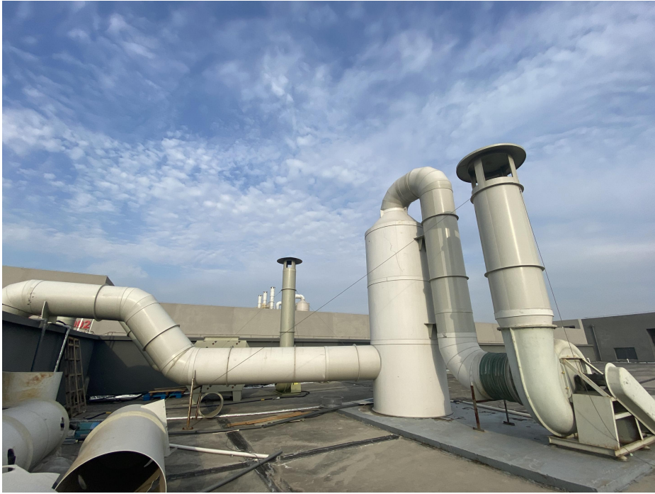
图 4.1-4 厂区废气治理设施实图（二期）
