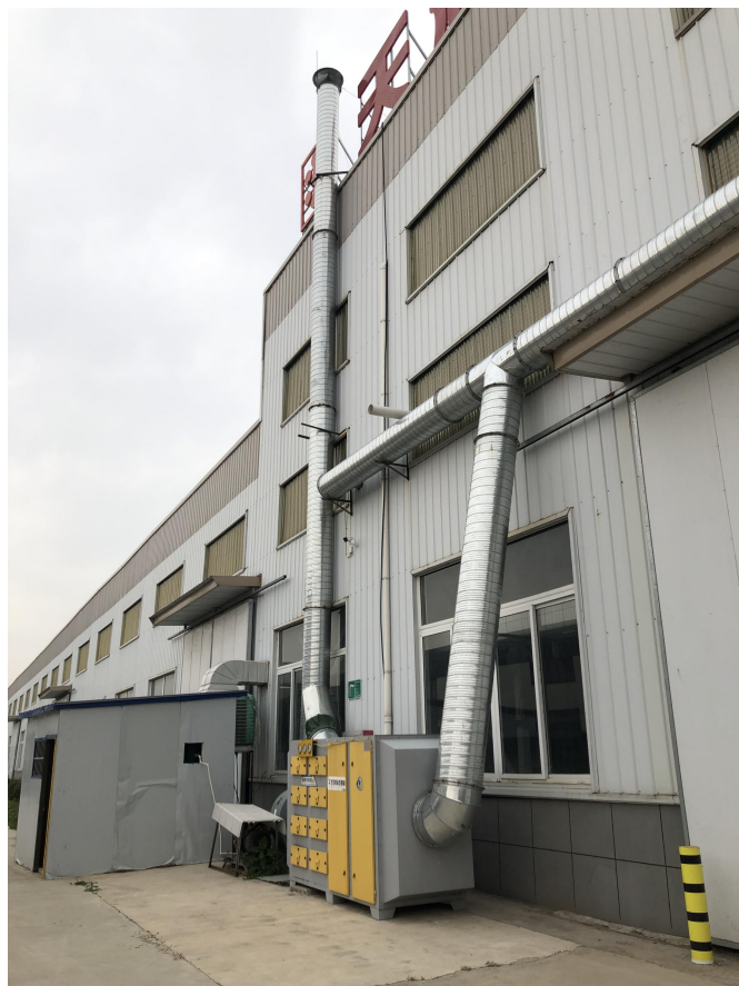
图4-6 排气筒及废气排放口标识牌
