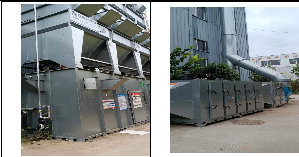
图4-1 废气环保设施及环保标识牌
