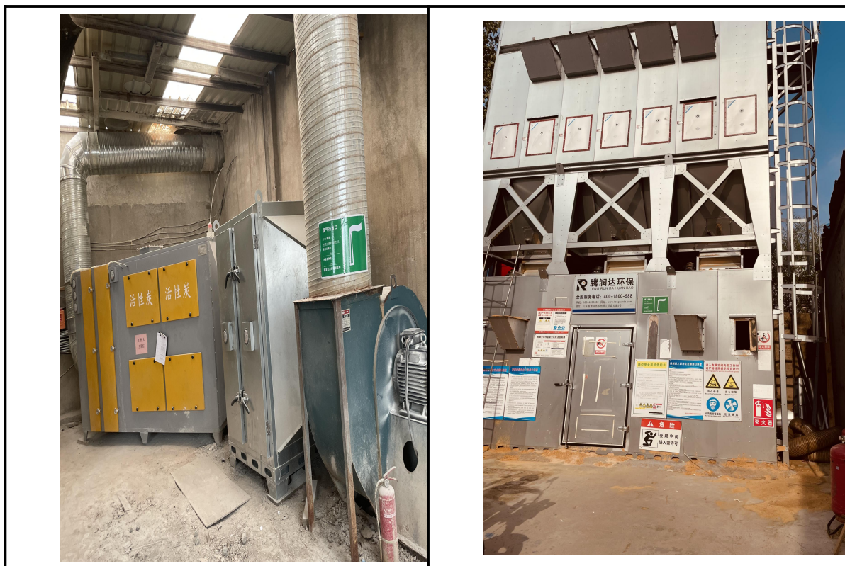
图4-2 废气环保设施及环保标识牌
