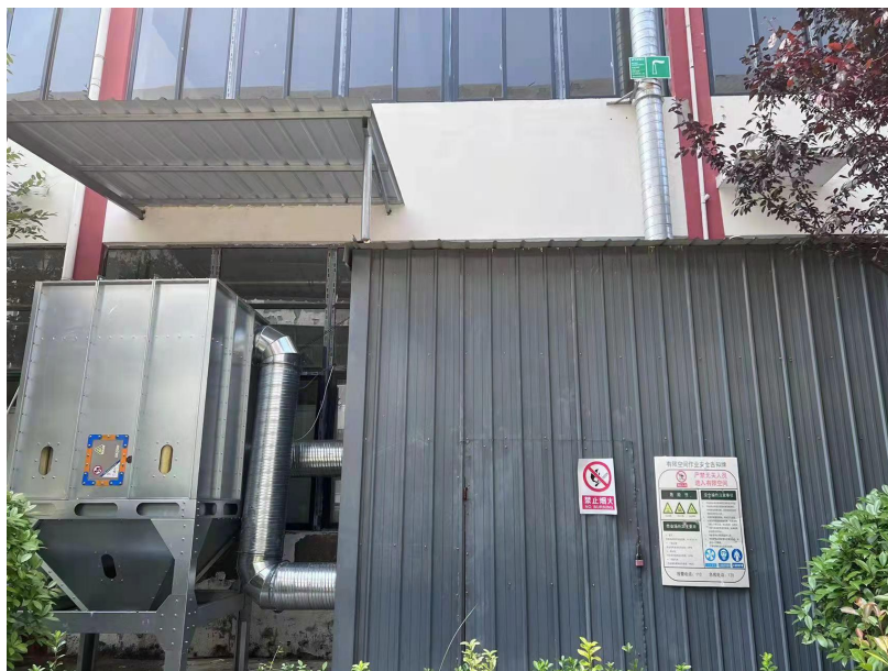
图4-1 焊接废气治理设施及排气筒
