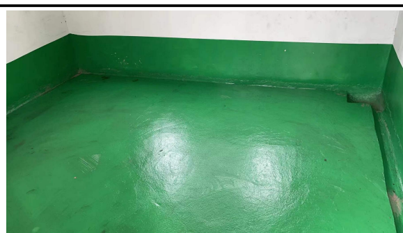
图4-7 危废间防渗地面
