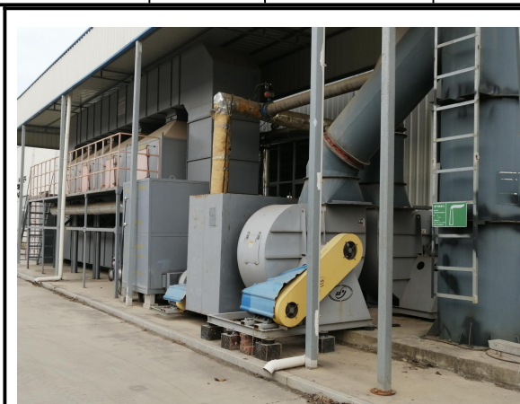
图4-2 催化燃烧设施
