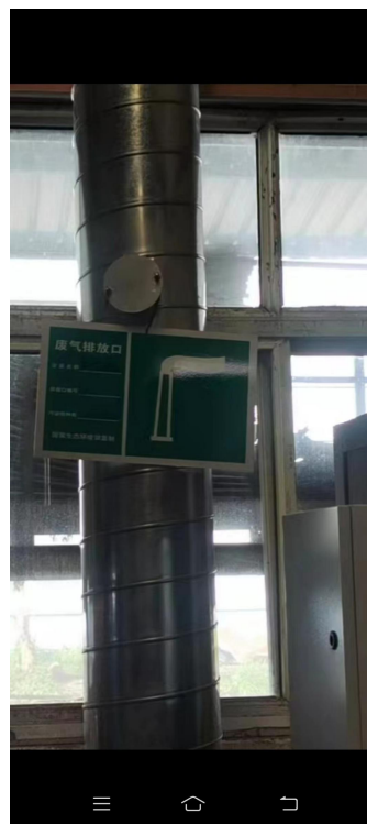
图4-7 废气排放口标识牌
